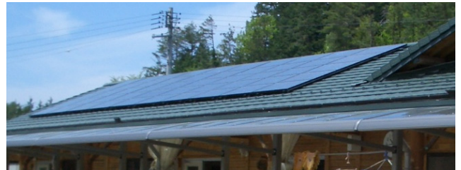
写真1 屋根上のPVパネル
